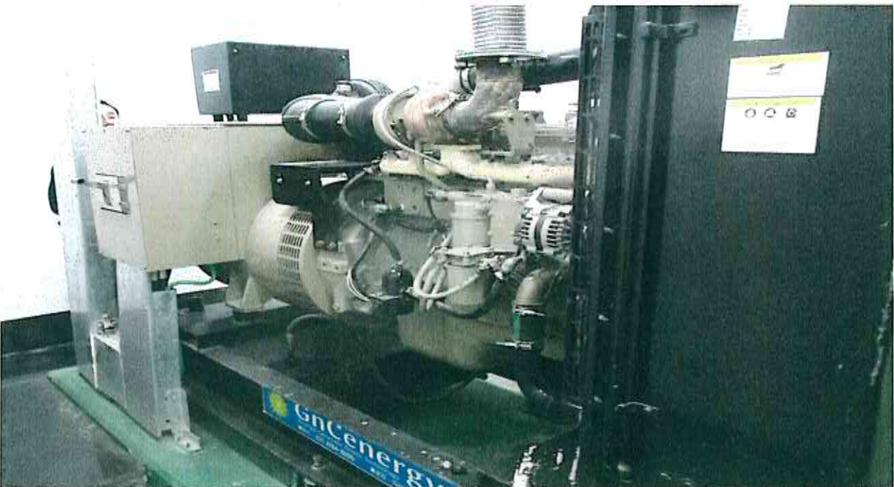
본건내부(기계실/지하4층 및 PIT)
